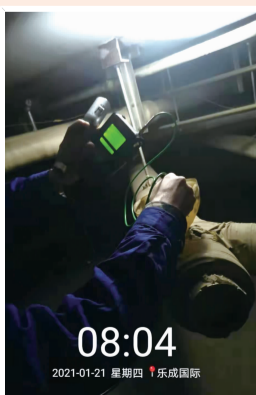
工作人员检测后未发现燃气泄漏情况
