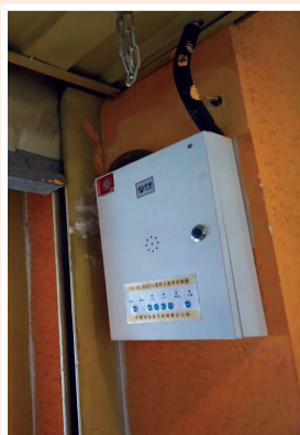
维修后的卷帘门报警器
